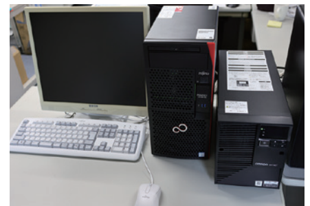
BIMデータ管理の専用サーバーとUPS
